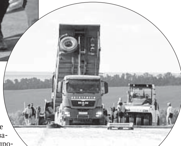
Дорожное покрытие к аэропорту сделают из современных материалов, чтобы трасса прослужила дольше
